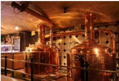
Würzpfannen einer modernen Brauerei. In solchen auch Sudpfannen genannten Behältern wird die Würze während der Bierherstellung erhitzt.
